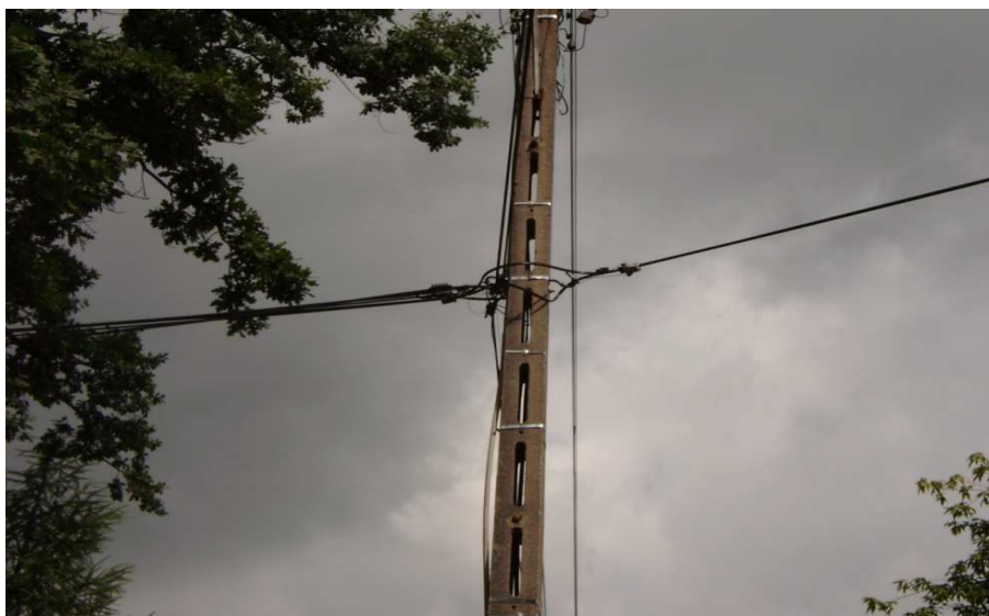
rys. 14. Kabel światłowodowy typu „ósemkowego” zainstalowany na słupie niskiego napięcia w terenie zabudowanym 15
